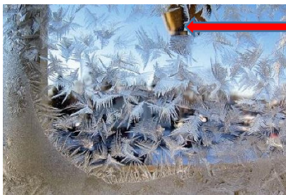
Ijsbloemen op de ramen in een zeer slecht geïsoleerde woning.
